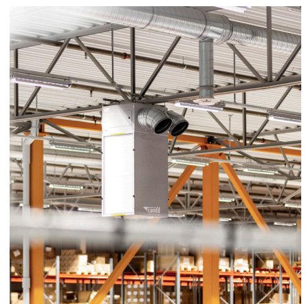
Luftcirkulationen från luftrenarna skapar en jämn temperaturfördelning, vilket sparar energi vid uppvärmning.
